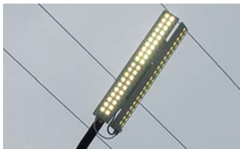
Светильник мачтового освещения
