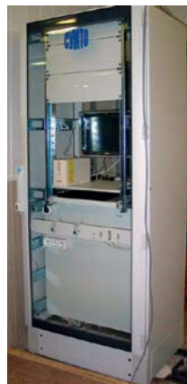
Шкаф автоматизированного рабочего места
