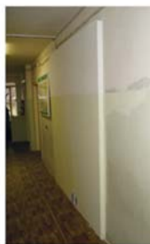
Смонтированный теплоаккумулятор СТЭ типа «Стена» с входными и выходными отверстиями
